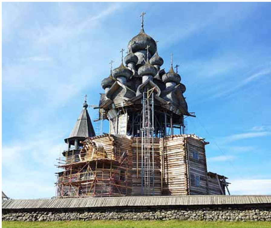
Рис. 2. Преображенская церковь Кижского погоста в процессе реставрации, вывешенная на металлических конструкциях. Фото музея «Кижжи»
